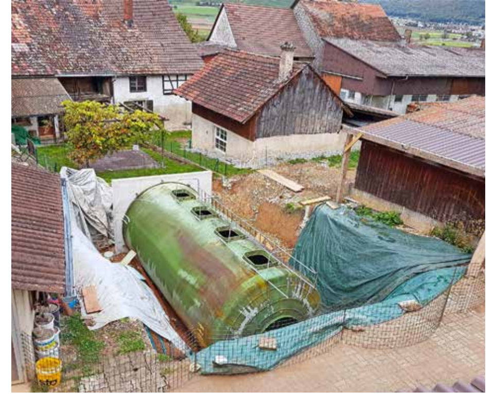
Der Silo wurde umgelegt und fasst jetzt als Zisterne 71000 Liter Regenwasser. BILD ZVG
