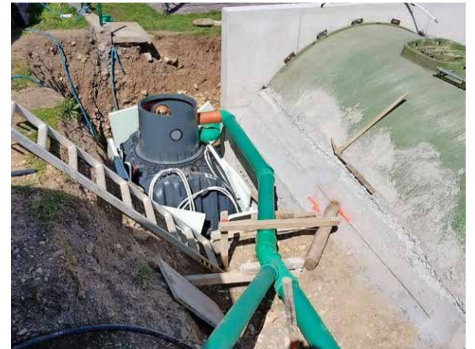
Nachdem das Wasser über das Ziegeldach geflossen ist, wird es in dem grauen 3000-Liter-Isoliertank gespeichert, wenn es warm genug ist. Sonst fliesst es eine weitere Runde. BILD ZVG
